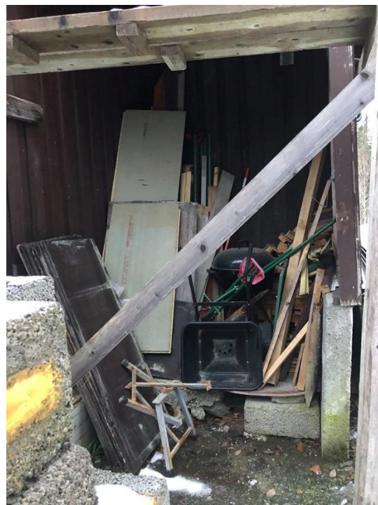
Må rydd bort ting og lage ny murer fra bunn m leca
