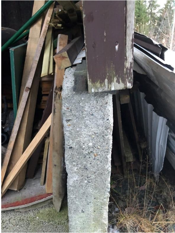
Skjev mur mot treverk bunn
